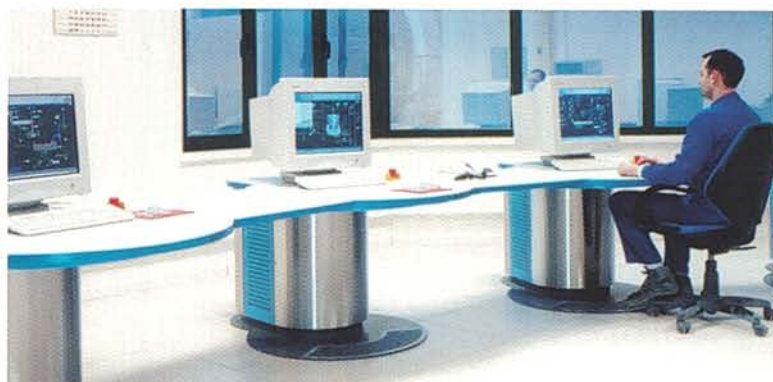
Poste de contrôle moderne avec système de conduite de procédé POLCID® NT.
