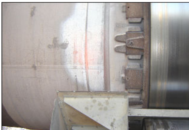
Chute de brique / Nouveau point chaud
