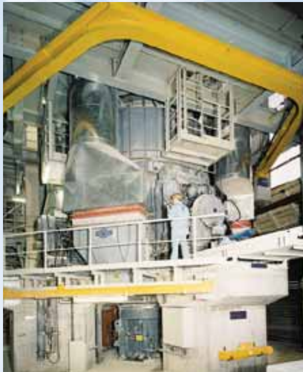
QUADROPOL® dans une cimenterie du Sud de l'Allemagne.
