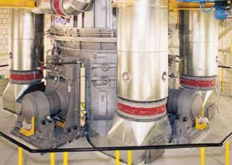
Arrivées des gaines gaz chauds.
